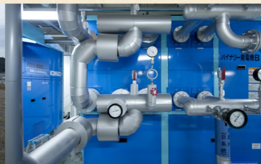
こちらが発電機。全部で3台あり、リアルタイムで発電量もわかります。
